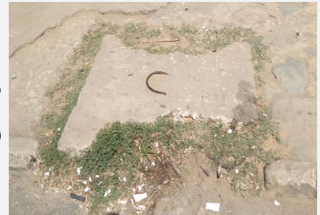
Fig. 7 – Boca coletora entupida
