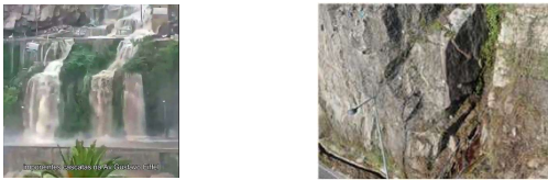
Figs. 1A e 1B - Inundações na escarpa em zona estabilizada com rede e pregagens
